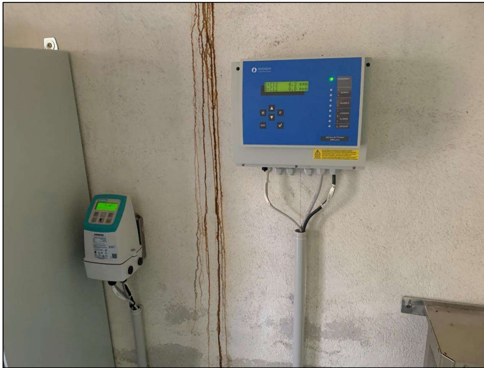
Figure 7 : Mesure du débit (gauche) et du chlore (droite) dans le local technique
